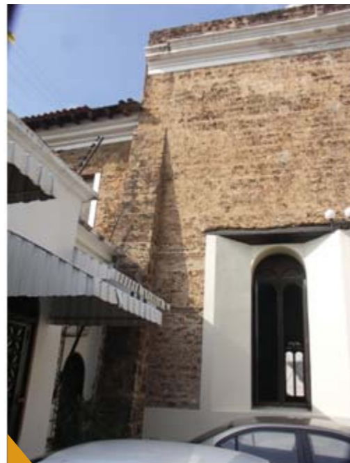
Fig. N° 4. Antigua Catedral de Maracaibo. Cornisa que marca la altura original de los techos de las capillas laterales. Fotografía: Arq. Mario Biancardi. 2005
