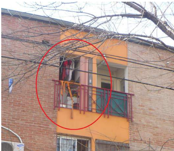
Imagen 21: Foto de alteración de uso del espacio. Balcón convertido en lavadero. Complejo Palos 460. CABA. 2013
