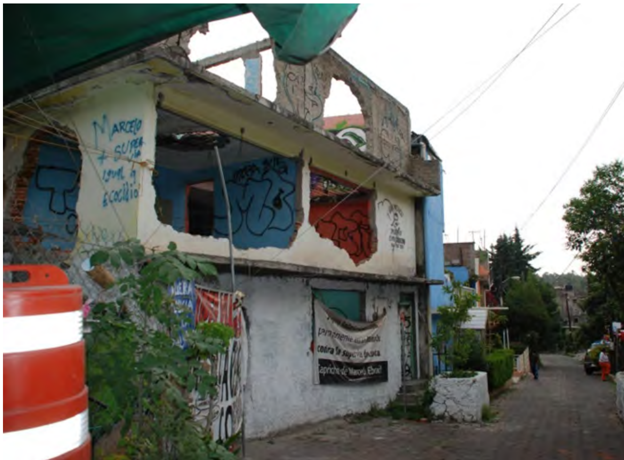
IMAGEN 2: EL CAMPAMENTO (A LA IZQUIERDA) JUNTO A CASA PARCIALMENTE DERRUMBADA.
