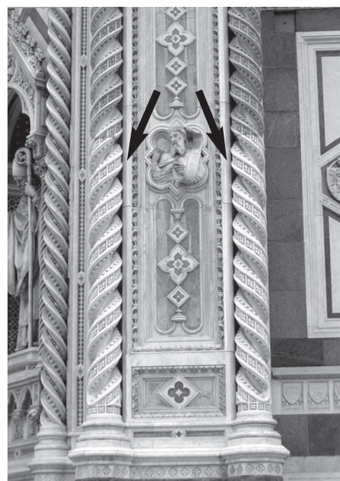
Fig. 6. Firenze: Duomo di Santa Maria del Fiore, colonne tortili poste a destra del portone centrale della facciata principali. Foto tratta dall'archivio personale.
