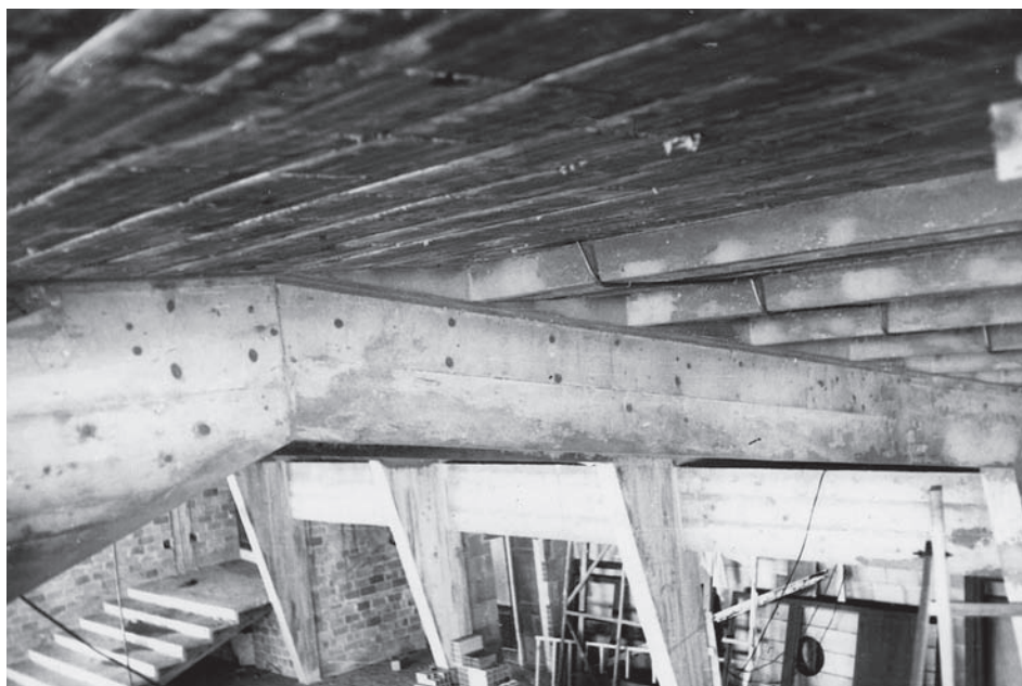
Fig. 14. Foto di cantiere. Particolare della struttura di sostegno della galleria. (Archivio MART, Fondo archivistico di Quirino De Giorgio, neg. Deg_S2_08.tif).
