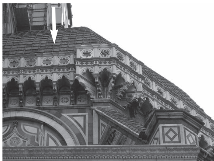
Fig. 4. Firenze: Duomo di Santa Maria del Fiore, particolare della Tribuna Sud. Ben evidenti a causa del contrasto cromatico i pezzi sostituiti. Foto tratta dall'archivio personale.
