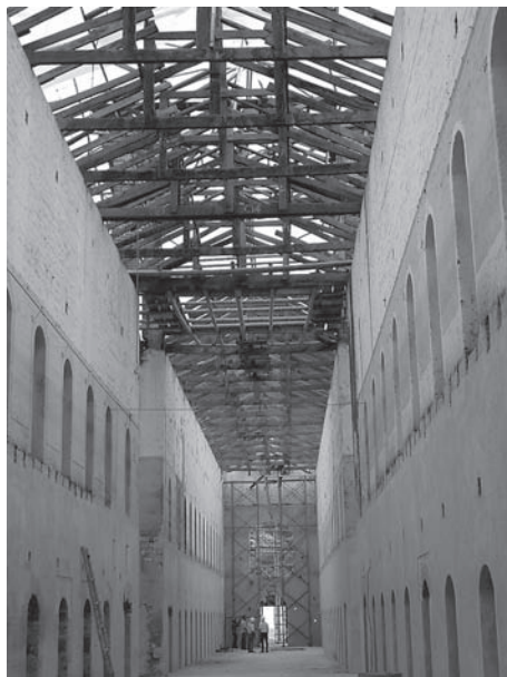
Fig. 8. Panoptico. Vista di un braccio della crociera durante i lavori di restauro (agosto 2007).
