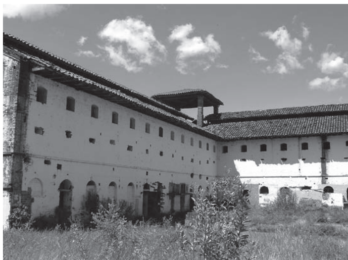
Fig. 3. Panoptico. Prospetti esterni in cui si rilevano evidenti alterazioni formali (agosto 2006).
