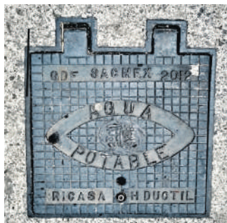
Figura 4.8. Registro de agua potable, localizado en la banqueta de estudio
