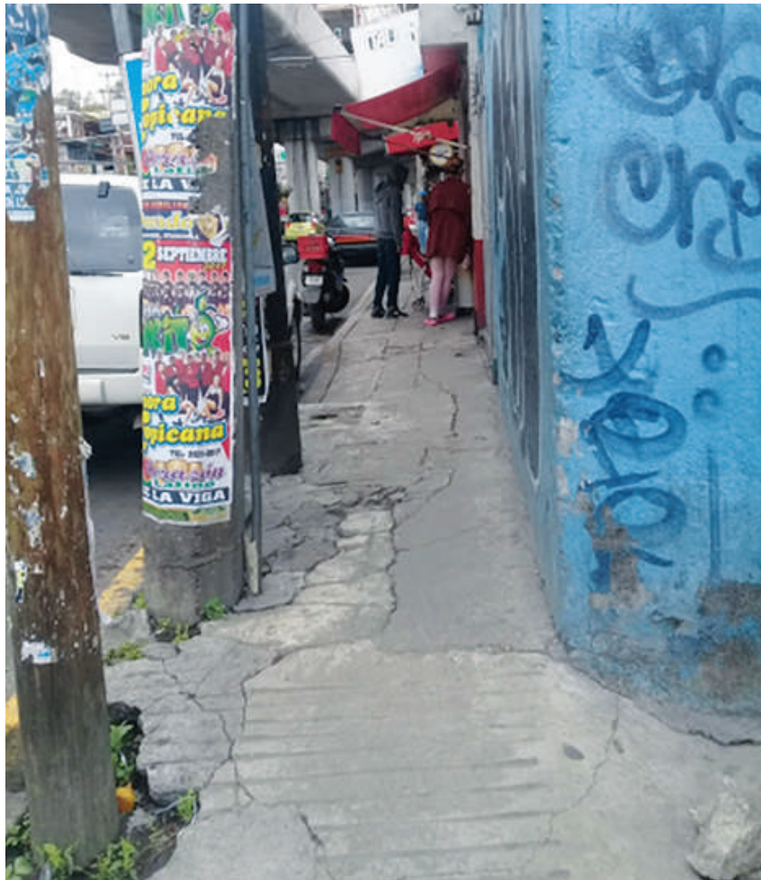
Figura 8.4. Banqueta estrecha y en mal estado. Postes que entorpecen el paso, vías del Sistema de Transporte Metro en la parte superior
