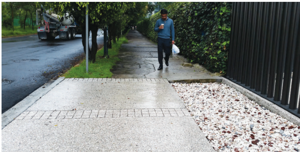
Figura 11.3. Límite entre la banqueta contigua al corporativo Calakmul y la banqueta de otro predio
