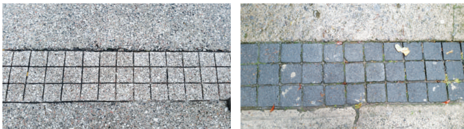
Figura 11.4. Banqueta del edificio Calakmul (izquierda) y banqueta del predio contiguo (derecha)
