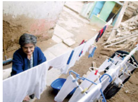
Derruida. La casona El Carmen fue una casa patio, muy bella. Por eso fue declarado monumento. Hoy, está por colapsar. (Foto: Eduardo Cavero)
