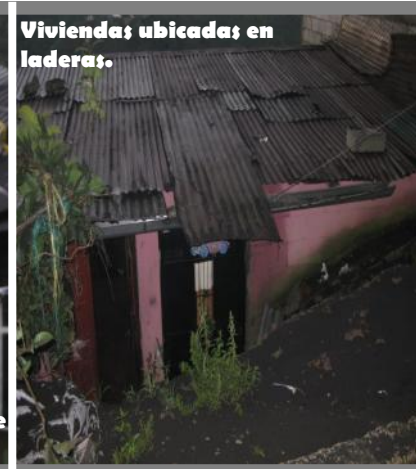
Arena daña las laminas de algunos techos.
