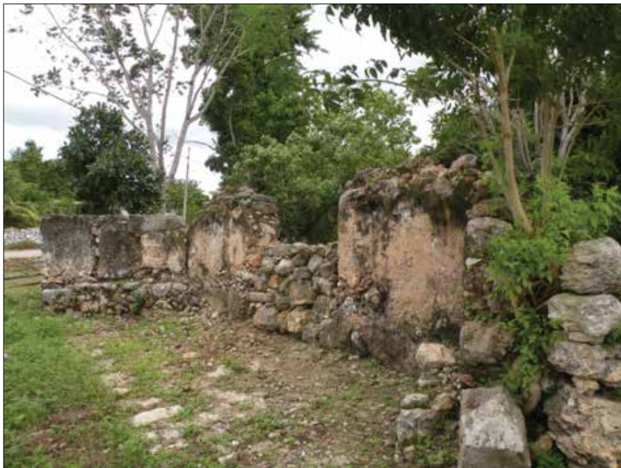
FIGURA 6. Casa maya destruida totalmente por el Huracán Isidore en 2002, Cacalchén (foto: J. A.).
