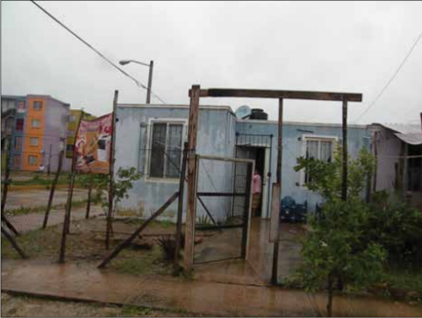
FIGURA 35. Casa del Fraccionamiento Ciudad Bicentenario con ningún desplante (foto: J. A.).
