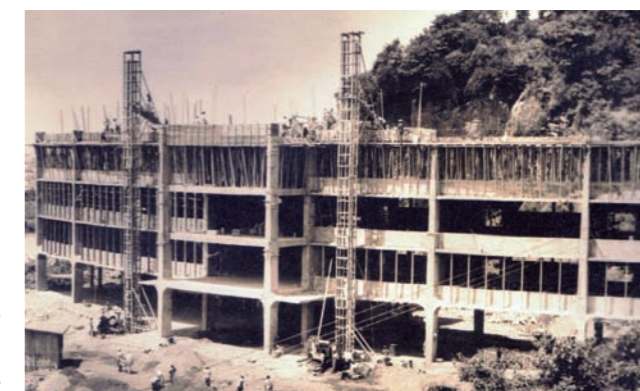
Figura 4 Construcción del edificio principal de la UCSG Biblioteca General "Dr. Francisco Illescas Barreiro" UCSG
