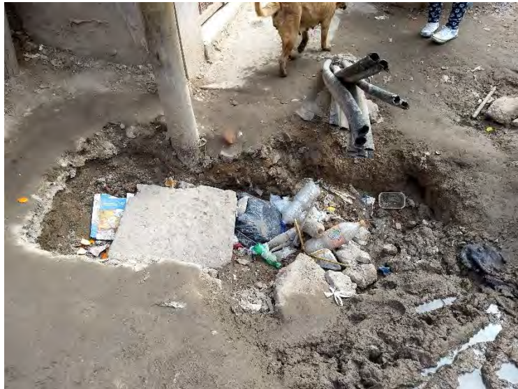
Figura 2. En la esquina de Chilavert y Corvalán se observa un pozo de importantes dimensiones (1 metro X 2,3 metros X 45 cm de profundidad). Se observa un poste de madera con riesgo de descalzarse en el borde del pozo. No se observa señalización ni cercado o vallado del pozo.
