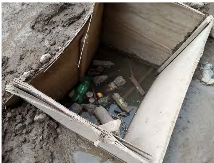
Figura 5. Sobre la calle Corvalán a pocos metros de la esquina se observa una cámara con encofrado sin tapa de 0,80 metros X 1,20 metros y 1 metro de profundidad. La cámara presenta 40 cm de agua y residuos. No se observa señalización ni cercado o vallado de la cámara.
