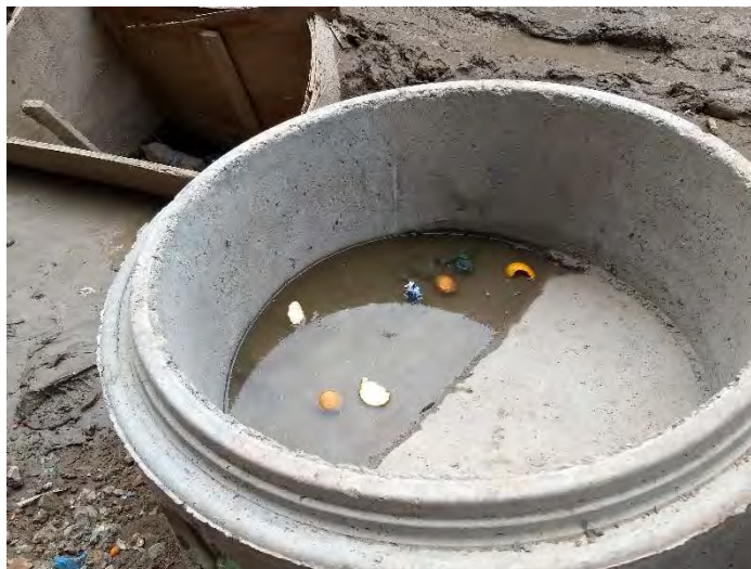
Figura 4. Se observan restos de cámaras premoldeadas con agua y residuos sobre la calle Corvalán.
