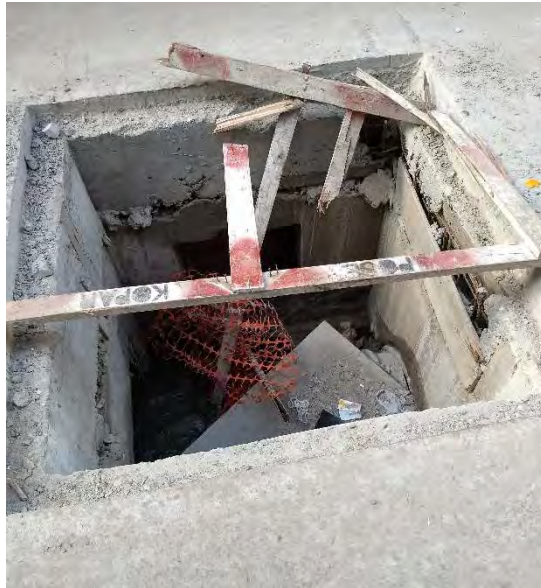
Figura 8. Frente a la Manzana 22 aproximadamente a la altura de la Casa 80 se observa una cámara con descarga cloacal sin tapa de 1,50 metros X 1,50 metros y 1,80 metro de profundidad. La cámara presenta 30 cm de tirante líquido cloacal y residuos. No se observa señalización ni cercado o vallado de la cámara.
