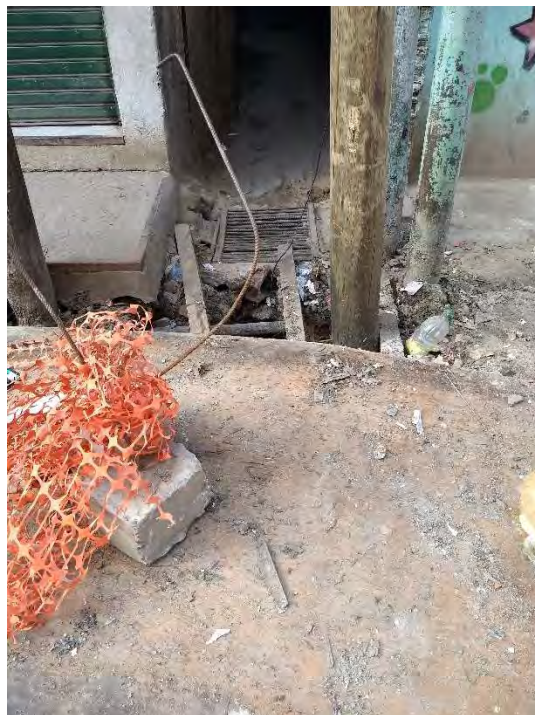
Figura 9. En el acceso al pasillo ubicado sobre la calle Corvalán a la altura de la Casa 121 de la Manzana 20, se encuentra un pozo parcialmente descubierto que impide el
