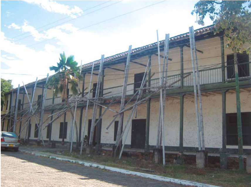
En la construcción se evidencia acelerado deterioro (2014). Fuente: Rastro Urbano
