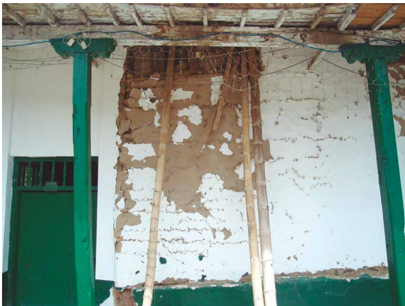
Figura 3.3. Fotografía del deterioro de una de las viviendas del Centro Histórico del municipio de Ambalema (2014)
