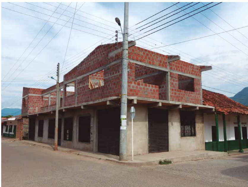
Figura 3.7. Fotografía que evidencia la construcción de viviendas de estilo arquitectónico contemporáneo en el Centro Histórico del municipio de Ambalema contraviniendo la normativa de Bien de Interés Cultural (2014)
