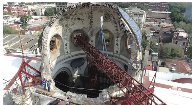
Figura 11. Fotografía donde se observa el proceso minucioso de montaje de las estructuras de acero. Fuente: SACBBE, agosto de 2020.
