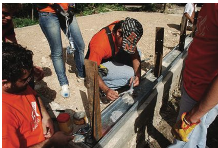
Figura 5. Colocación de grout en la tornillería para la instalación de los pies derechos de los marcos de las capillas. Pedro Moreno, noviembre de 2011. Fuente: E.P.
