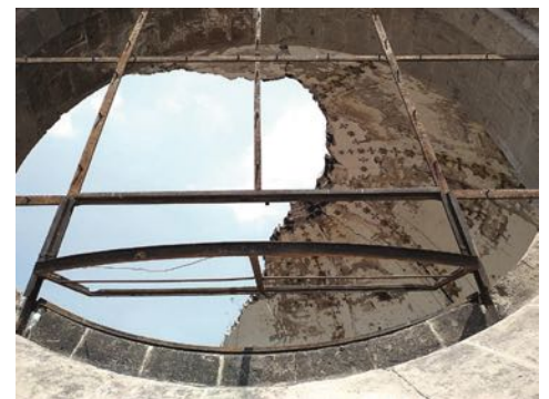
Figura 1. Vista Aérea de la Cúpula del Santuario de Nuestra Señora de los Ángeles después de su colapso parcial. Imagen de septiembre de 2017, autor: SACKBÉ.
