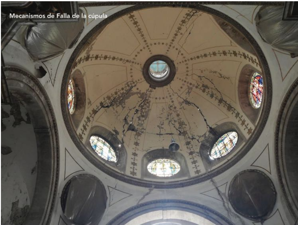
Figura 6. Fotografía donde se observa la cúpula fracturada en forma más acentuada en las tres secciones centrales de la parte sur del santuario después de los daños del sismo del 19 de septiembre. Días después, las tres secciones centrales colapsarían. Fuente: Fotografía de SACKBÉ.
