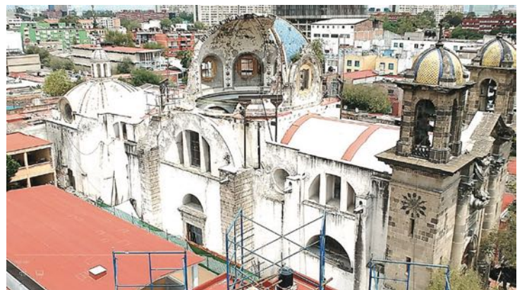
Figura 2. Vista aérea del conjunto y contexto inmediato donde se localiza el Santuario de Nuestra Señora de los Ángeles, al inicio de la consolidación de la cúpula colapsada. Imagen de julio 2020, autor: Oscar Ibarra V.
