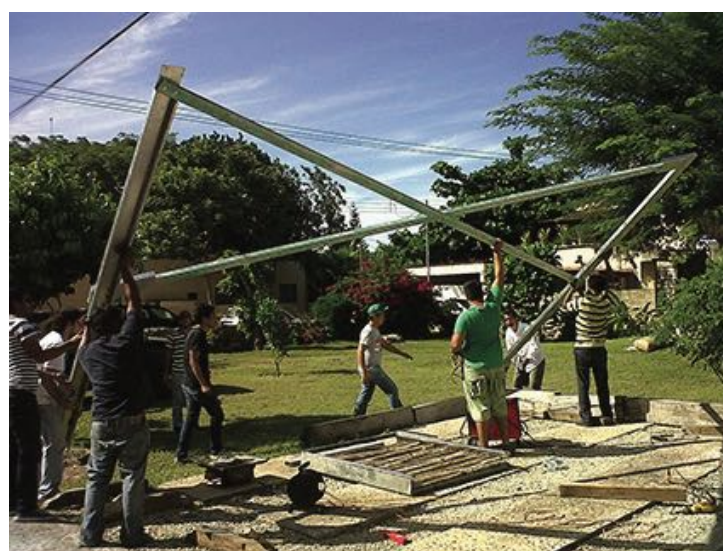
Figura 4. Pruebas de ensamble previas a la manufactura general de las piezas para las dos capillas. Fuente: E.P., 2022 (imagen de 2011).
